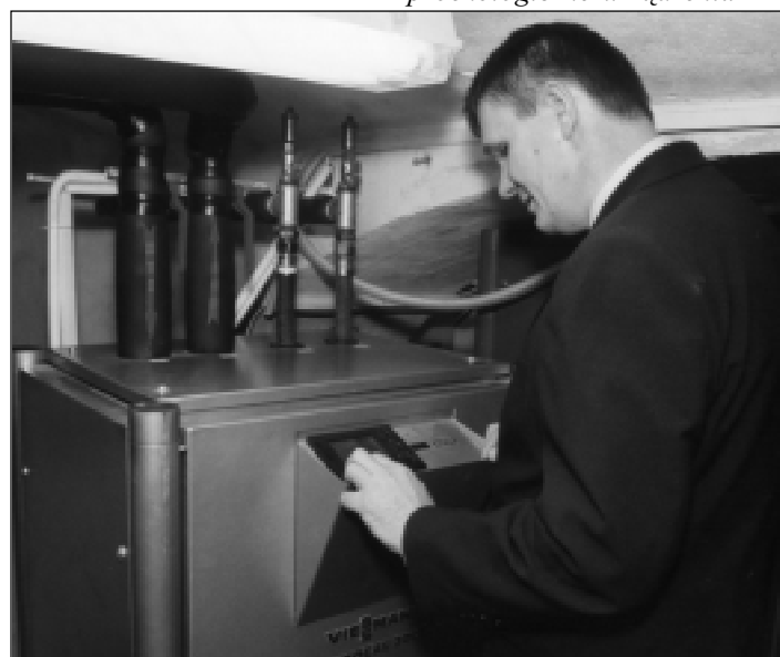
Główny projektant inwestycji - inż. Henryk Kowalski programuje komputer, który nadzoruje pracę nowej instalacji ciepłnej
